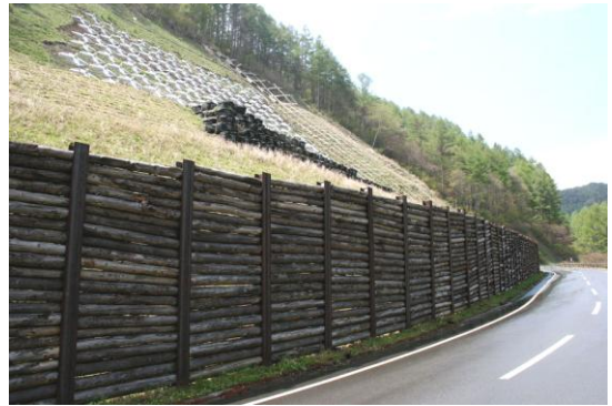
写真－7 木製落石防護柵
