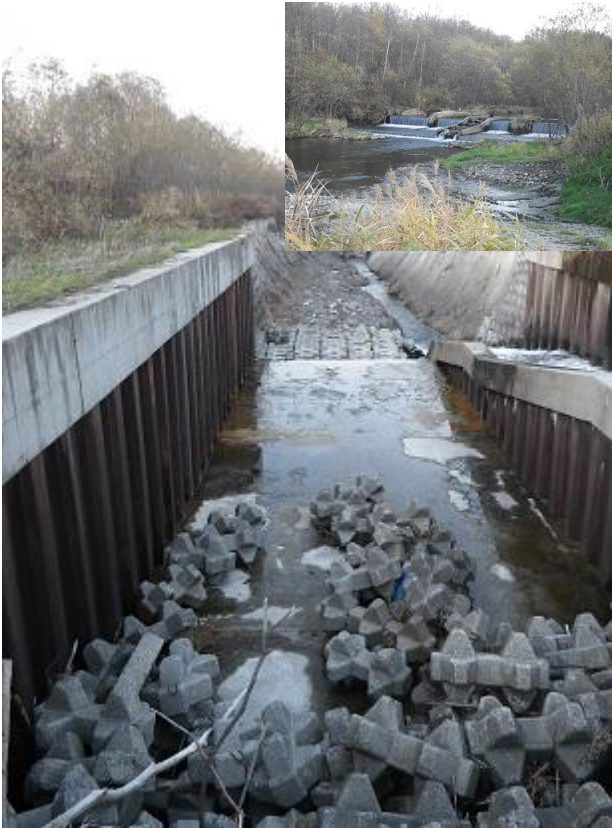
写真 17 砂防施設下流側の河床低下（写真右上は同時期に記録した砂防施設直下流側の状況）
