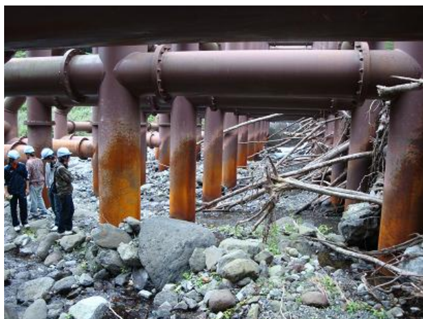
写真 22 鋼製えん堤によって補足された流木と巨石の隙間から通水される状態
