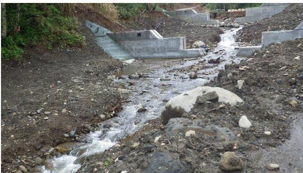
写真 19 スリット化された治山えん堤前後の河床低下
