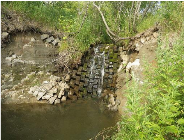
写真 7 本川の河床低下に伴う支川との合流点での段差（支川としての機能障害を受けた状態）
