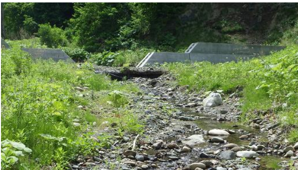
写真 18 スリット化された治山えん堤下流側の河床低下
