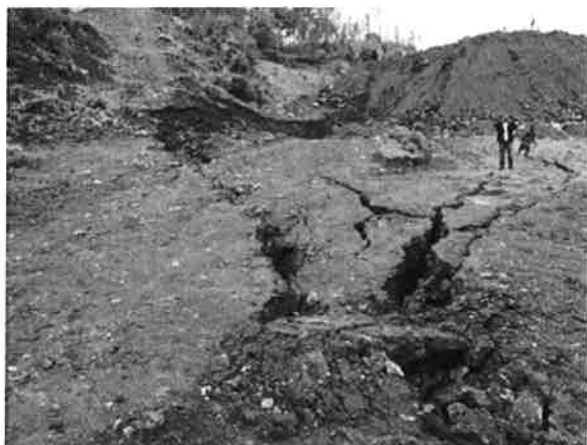
写真10 Mele+83km で発生した地すべり
