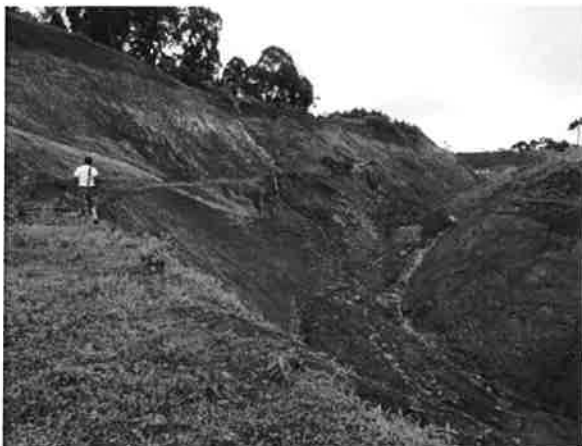
写真13 道路脇の崩壊と道路掘削面に流出した土砂
