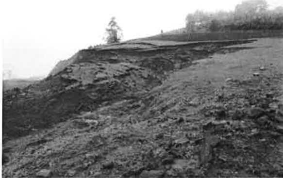
写真9 Mele+35km で発生した地すべり
