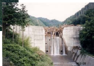
↓砂防堰堤(部分透 過型)による流木の 捕捉
