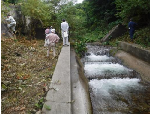
写真 14 切り下げた治山ダムと台形魚道
